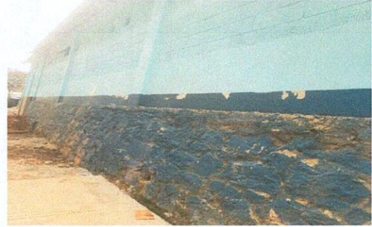
Foto 2: Pintura de establecimiento en mal estado
