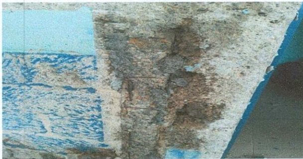
Foto 11: Muro en mal estado
