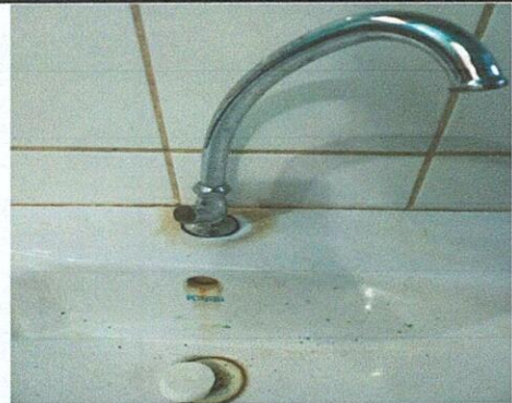
Foto 10: Lavamanos en mal estado y sin función
