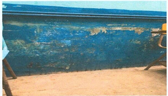
Foto 12: Pintura aula en mal estado.
