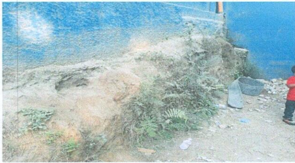
Foto 3: Muro perimetral de escuela en mal estado
