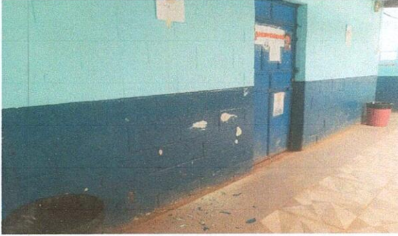
Foto 7: Pintura interior en mal estado
