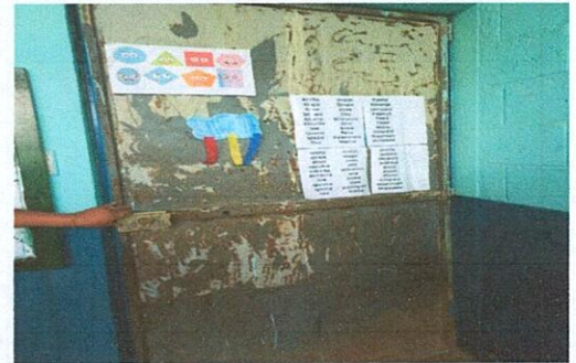
Foto 6: Puertas en deterioradas
