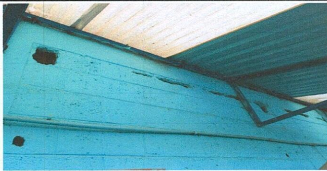
Foto 5: Techo en mal estado
