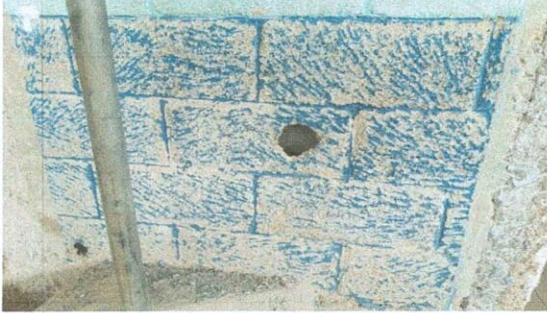
Foto 1: Agujeros en las paredes del establecimiento
