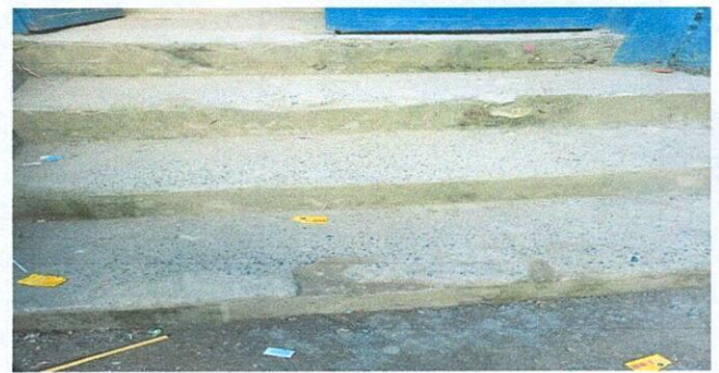
Foto 8: Gradas en mal estado
